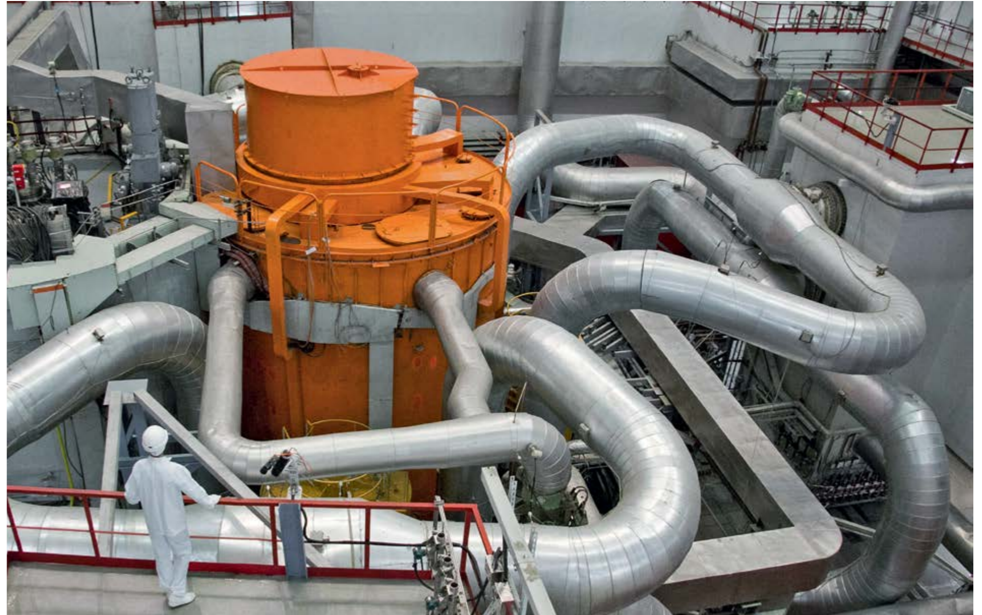
Справа: реактор БН-800 в энергоблоке № 4 Белоярской АЭС Внизу: Белоярская АЭС, где эксплуатируются реакторы БН-600 и БН-800
